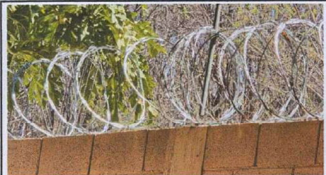
Foto 4: Sustrucción de alambre rasor sobre muro perimetral
